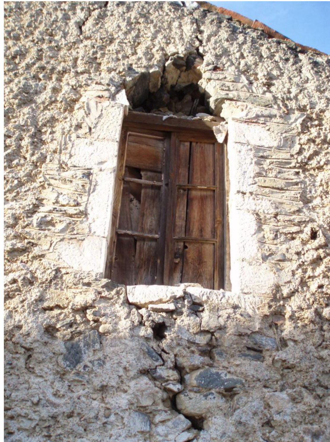
Ρηγμάτωση λιθοδομής λόγω της παρουσίας του ανοίγματος
