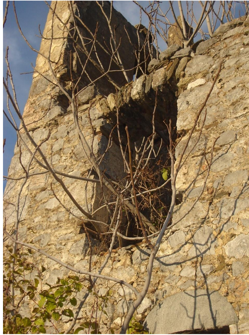
Κατάρρευση λιθοδομής ορόφου, στέγης και κουφώματος
