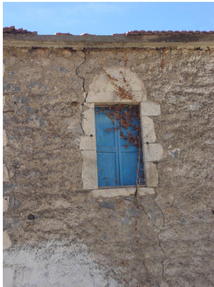
Τυπικές διαγώνιες ρωγμές που καταστρέφουν τους πεσσούς μεταξύ των ανοιγμάτων
