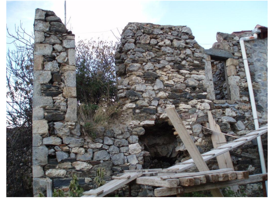
Κατάρρευση στέγης, παραθύρου και πατώματος
