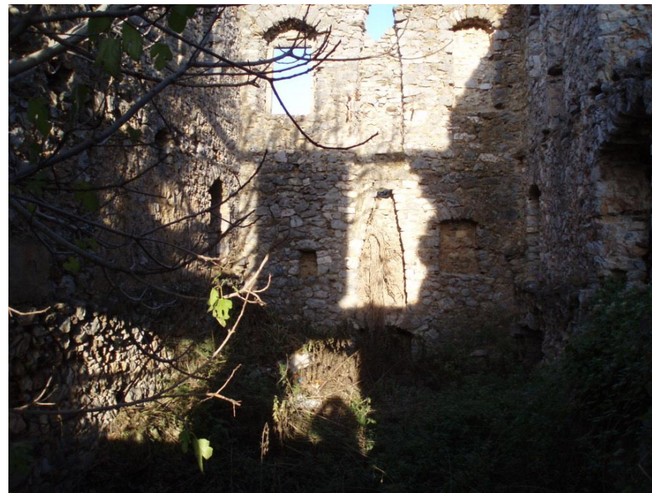
Κατάρρευση τζακιού, πατώματος και κουφωμάτων
