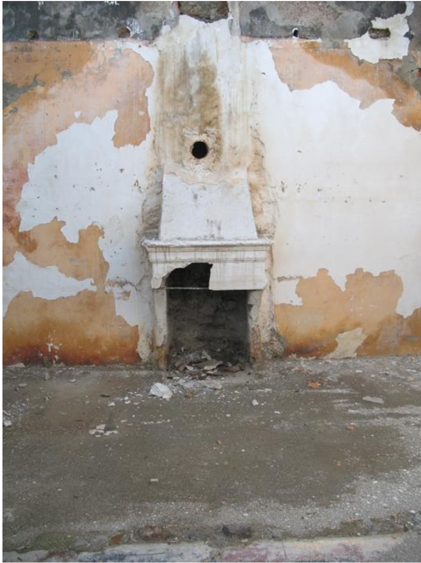
Καταστροφή τζακιού και τοιχοποιίας λόγω πυρκαϊάς
