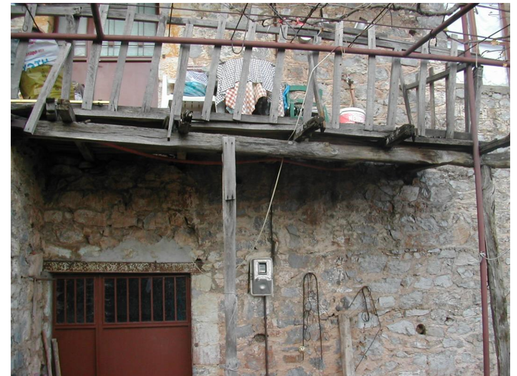
Χαγιάτι σε κακή κατάσταση
